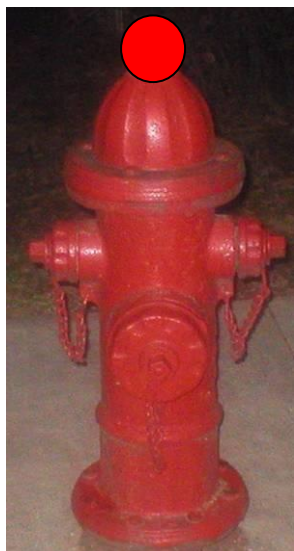
Figur 1: Eksempel på registrering av hydrant (rød prikk).
